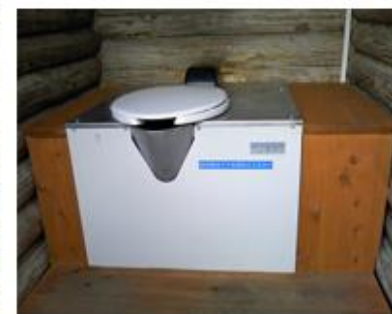
個室内に設置されたバイオトイレ
