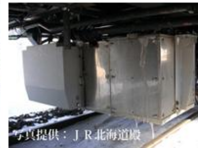
車両の床下に搭載された バイオ式尿尿処理槽。 ※処理槽表面には風雪による 氷が付着しています。
